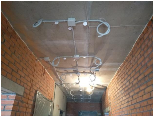
Устройство системы освещения в МОП
